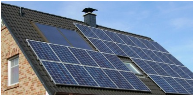
Рис. 3. Сонячні батареї, розташовані на даху будинку
